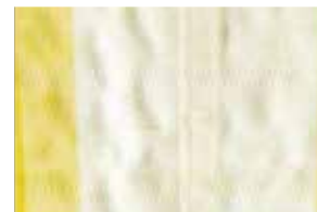
Skrynkelmärken vid söm. Crease marks along seams
